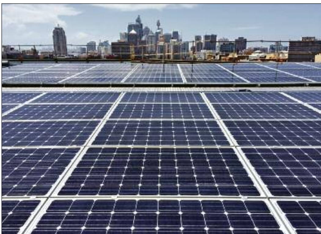
Photon Energy působí nejen na českém trhu, ale daří se jí pronikat i do Austrálie, Německa a Itálie. Na snímku fotovoltaická elektrárna, kterou tato firma instalovala v Sydney. Foto Photon Energy
